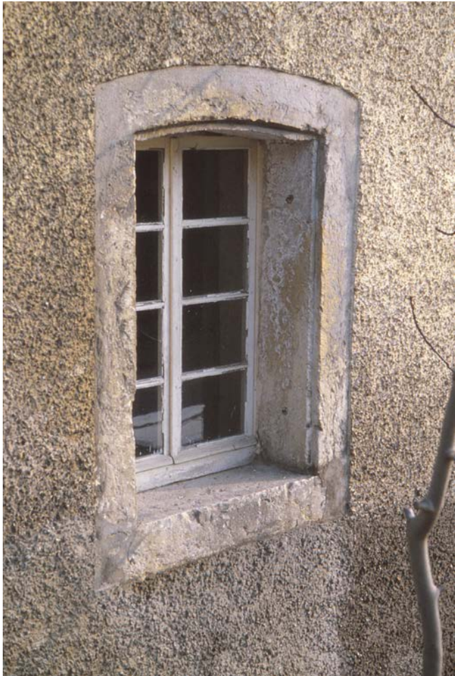
10 Das Segmentbogenfenster im Erdgeschoss auf der Südseite wurde nachträglich eingebracht. Dia, um 1980 (FLM BalFot 12454).
